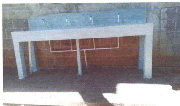
Foto 6: Pila en mal estado
